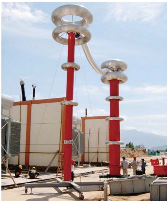
Резонансная система 1000 кВ / 6000 кВА для испытаний распределительных устройств с элегазовой изоляцией на 750 кВ на месте эксплуатации Hyosung
