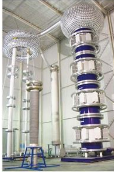
Резонансная система 1400 кВ / 28000 кВА Smart Transmission Engineering Technology Co.
