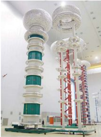
Резонансная система 2000 кВ / 20000 кВА State Grid Corporation of China
