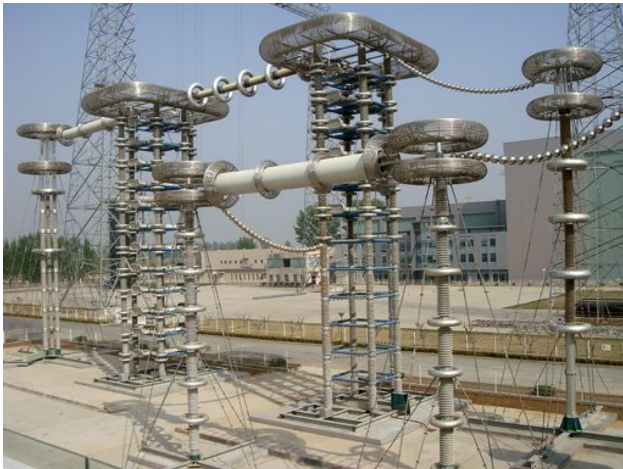
Высоковольтная система постоянного напряжения 1600 кВ / 2 А (испытания с загрязнением) China Power Electric Research Institute
